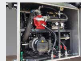
Impianto di protezione invernale
